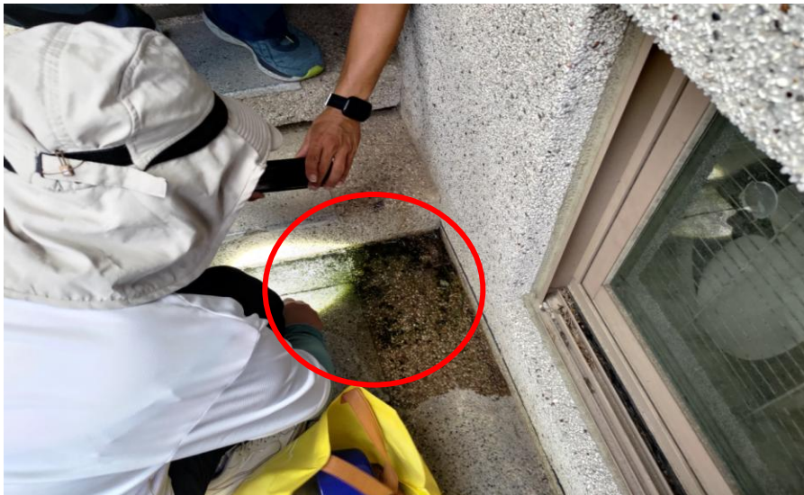
樓梯地面積水
