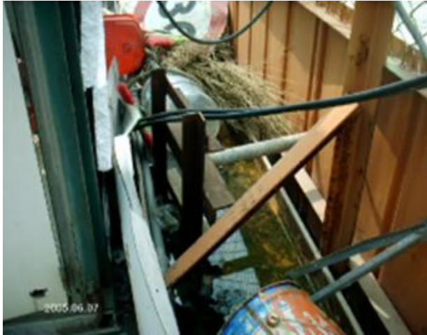
鋼架鐵板凹槽積水
