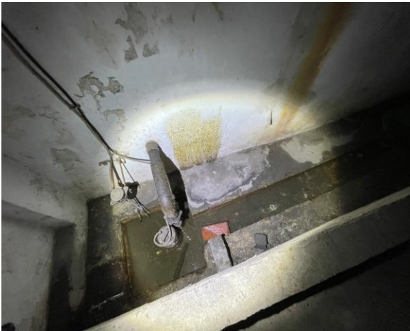
地下室集水井
